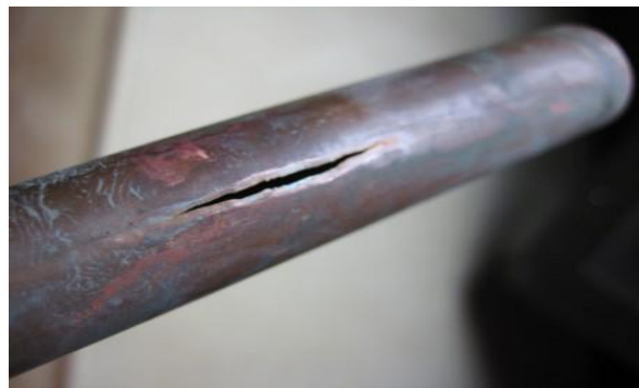
Fig. A.2(Burst pipe)
